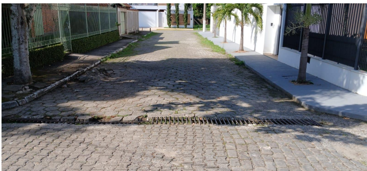
Figura 34. Canaletas de drenagem pluvial na Rua José Mastrangelo
